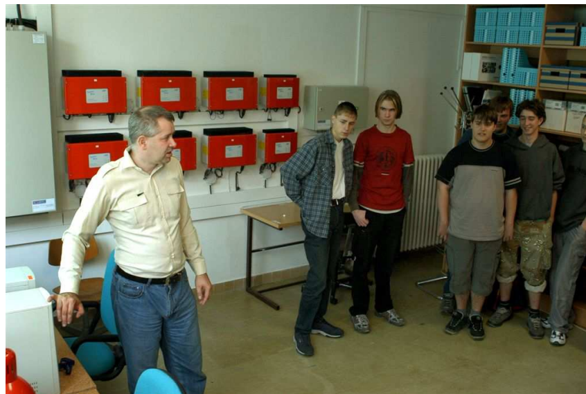
Primárně byla pořízenou technikou monitorována FVE s výkonem 20kW umístěná v místnosti NK501
