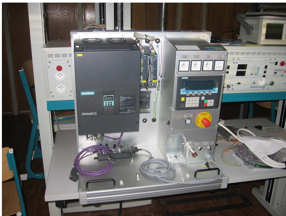
Laboratorní stanoviště s řízeným usměrňovačem SINAMICS DC - MASTER
